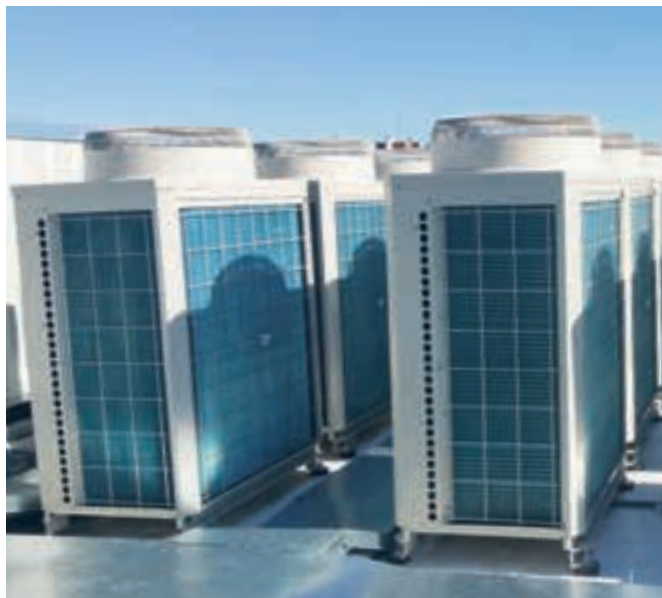
UNIDADES EXTERIORES EN CUBIERTA
