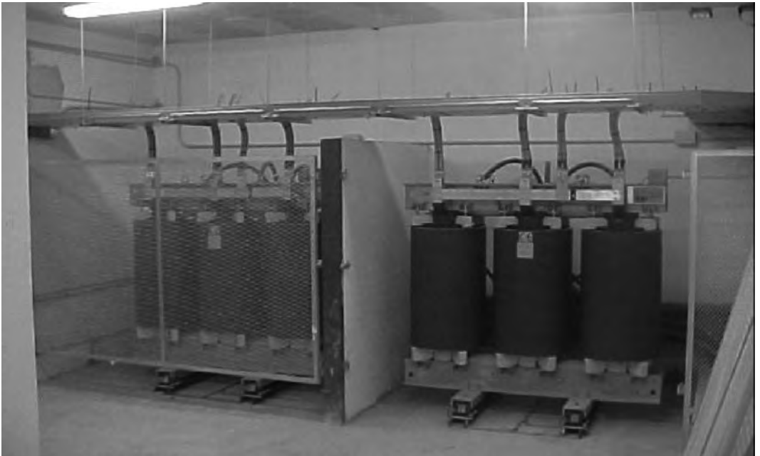
Centro de transformación
