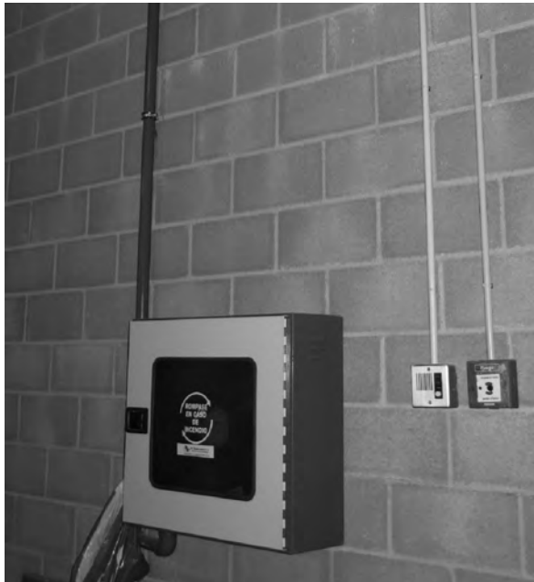
Elementos de protección contra incendios
