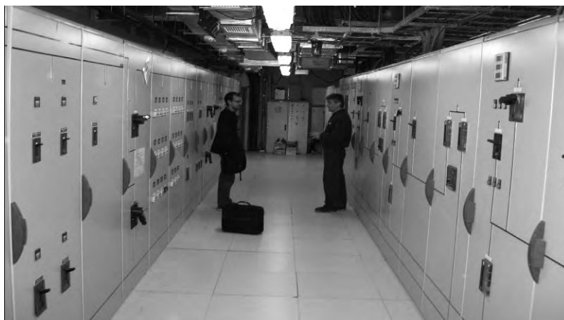
Cuadro eléctrico principal de distribución b.t.
