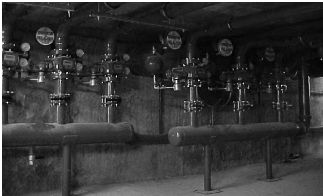
Punto de control de rociadores
