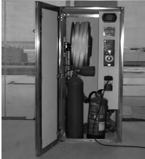
Armario de protección contra incendios
