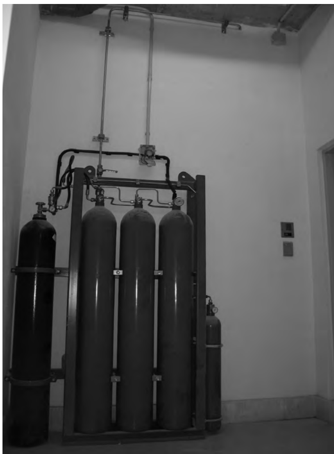
Extinción automática por gas
