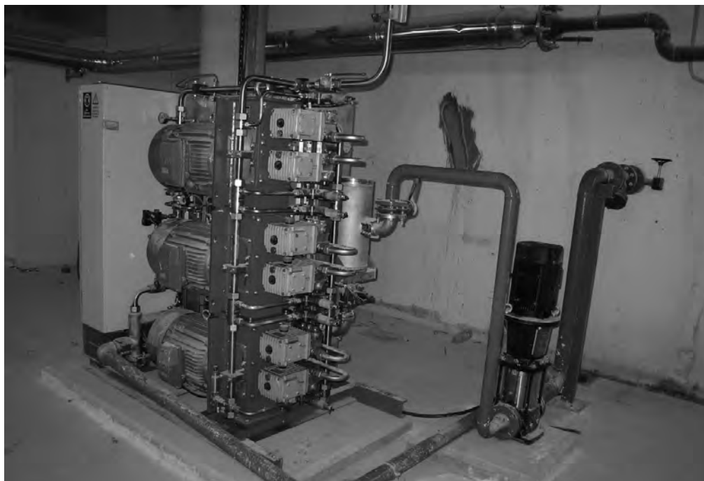
Grupo de presión contra incendios de agua nebulizada
