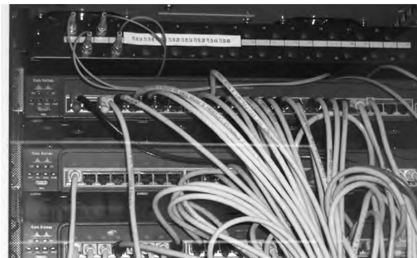
Conexión del rack de comunicaciones
