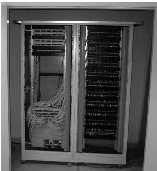
Rack de comunicaciones
