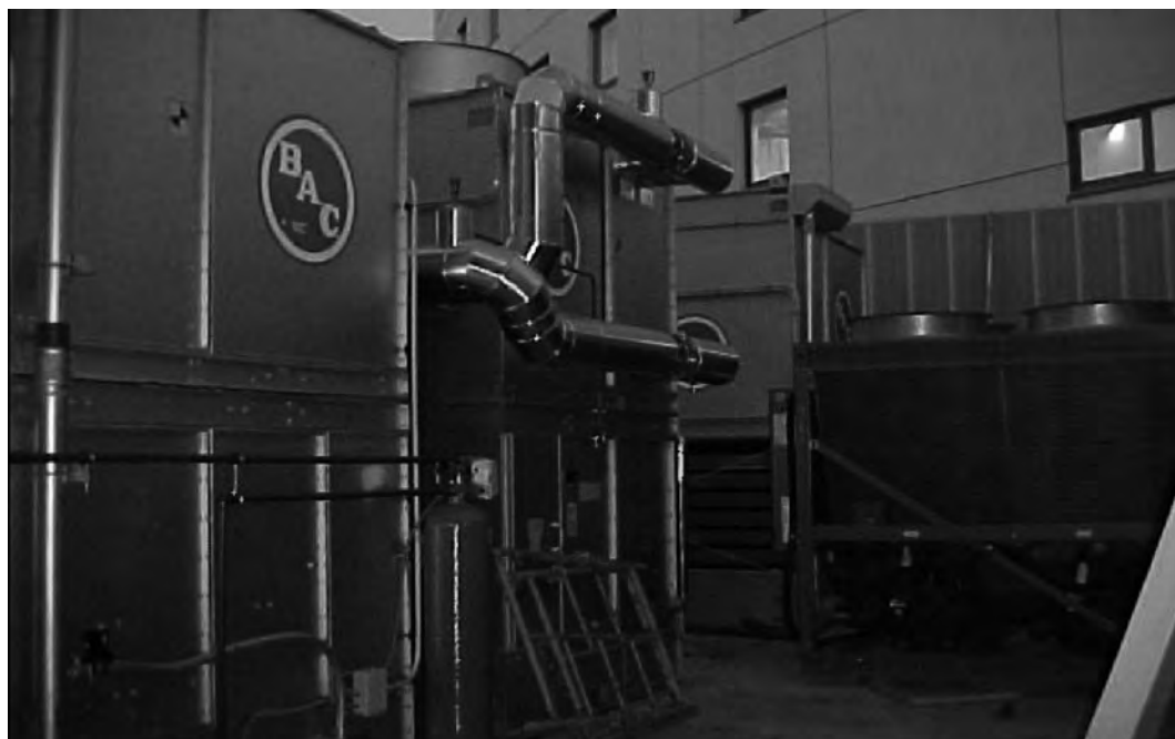
Torres de recuperación de agua
