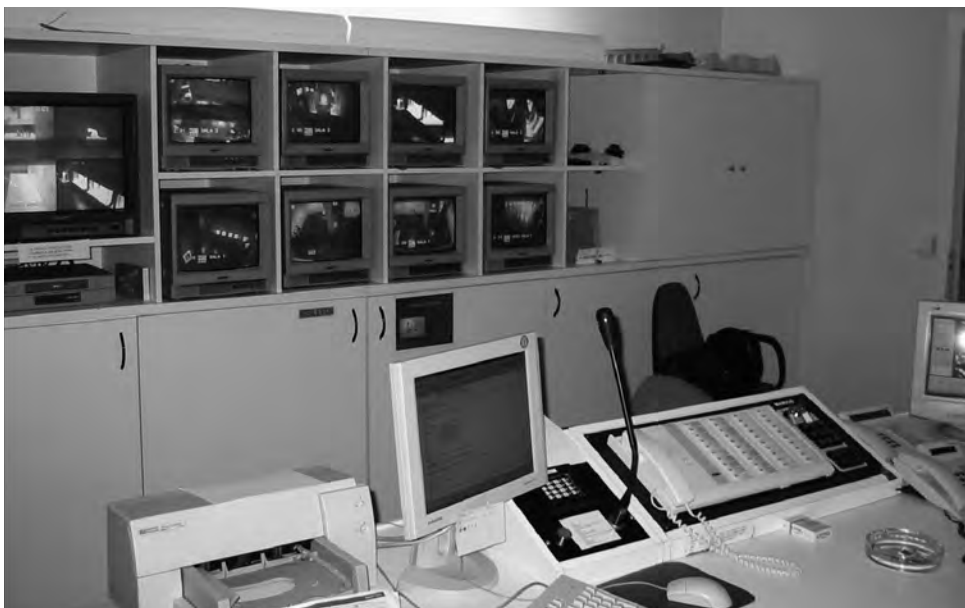
Salas de control del sistema de gestión y seguridad
