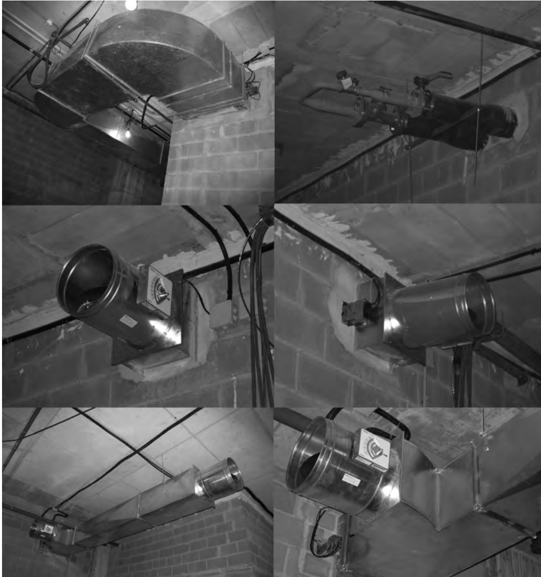
Tomas hidráulicas y de ventilación en locales
