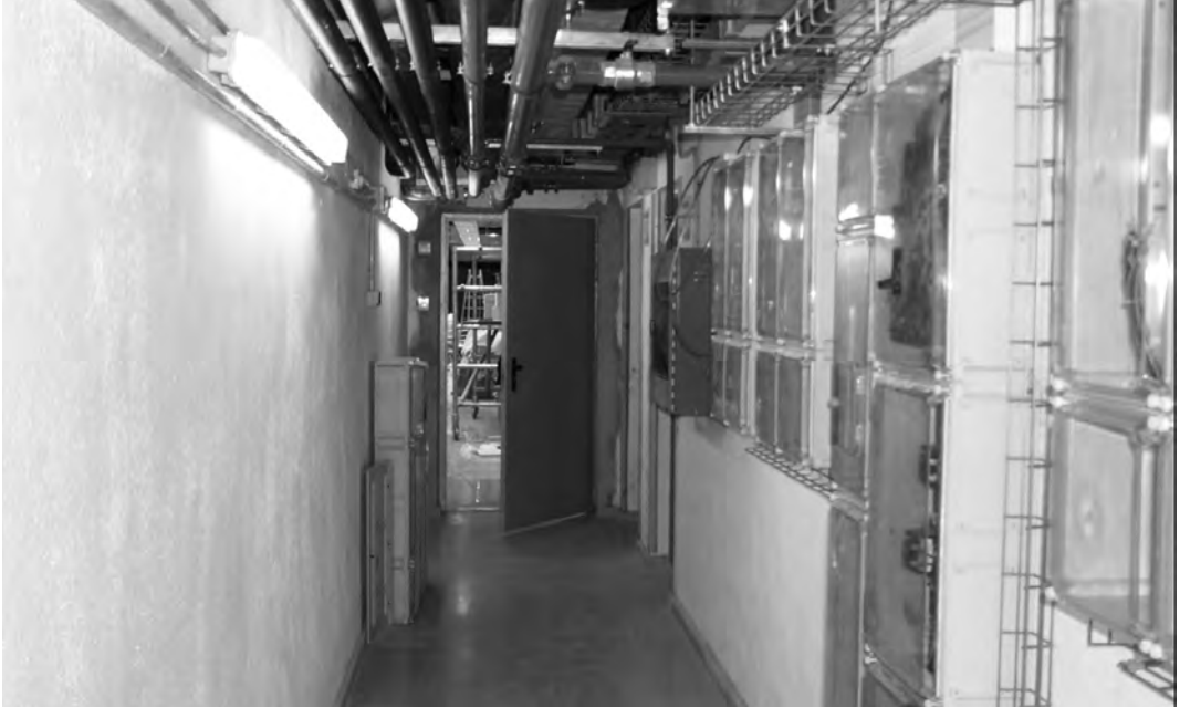
Módulos de contaje eléctrico en pasillos de servicio
