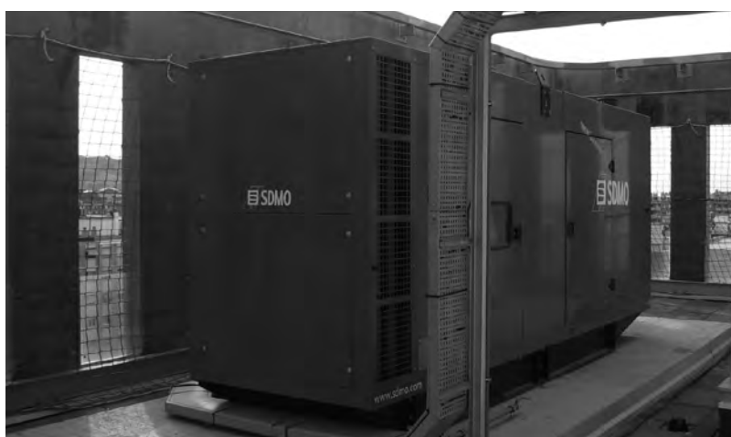
Grupo electrógeno de suministro de emergencia
