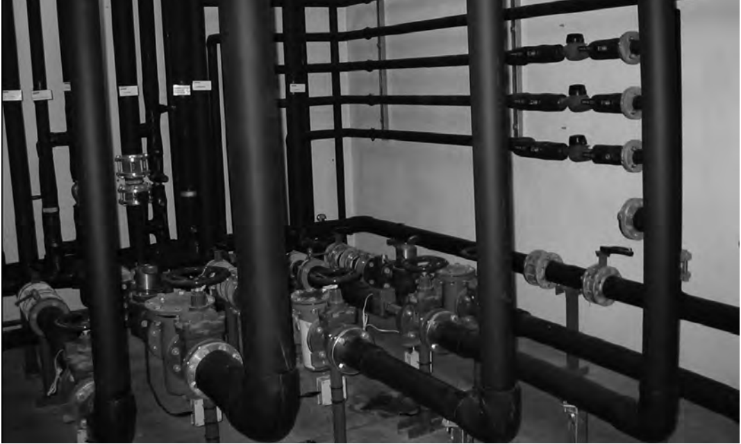
Centralización de los contadores de agua sanitaria
