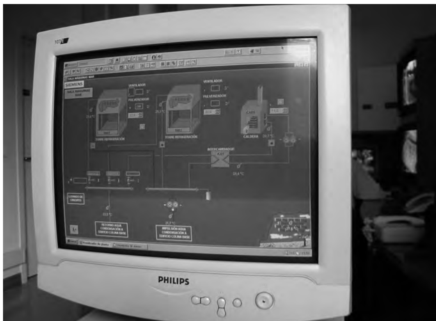
Salas de control del sistema de gestión y seguridad
