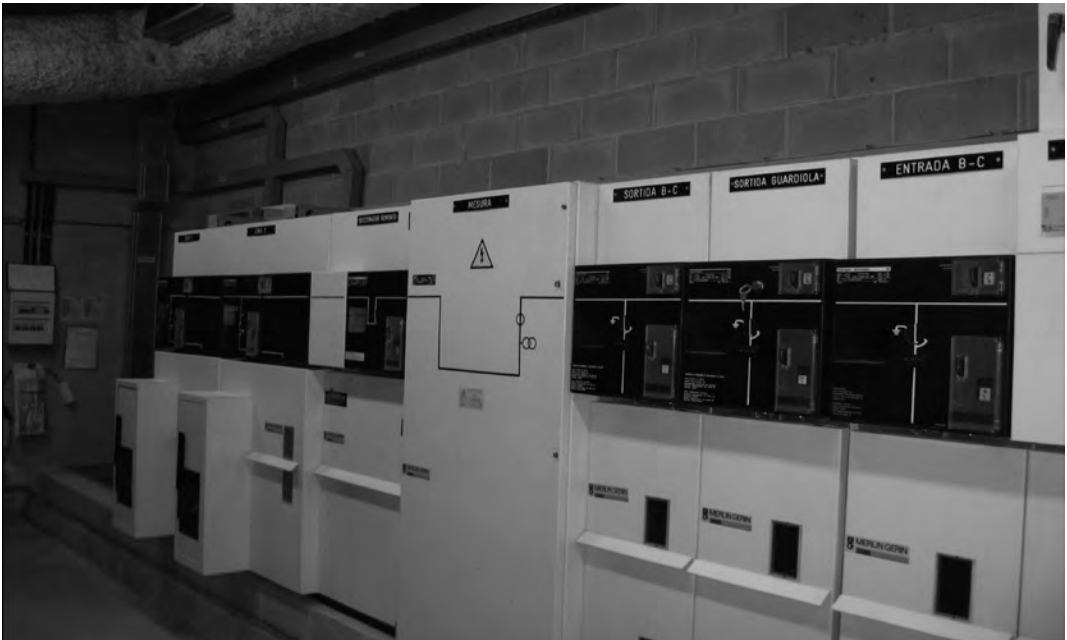
Cabinas prefabricadas de protección de media tensión
