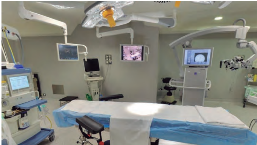
Quirófano equipado con sistema de procesado de imágenes
