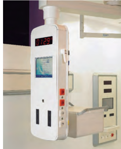
Sistemas de control de instalaciones quirófanos en torretas
