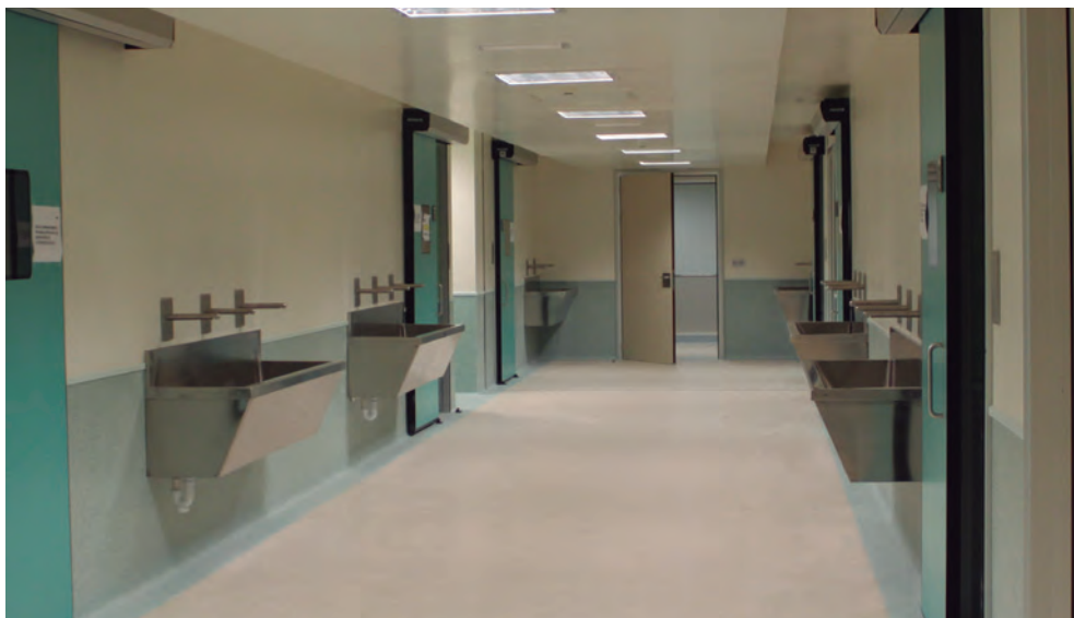
Conjunto de lavamanos quirúrgico
