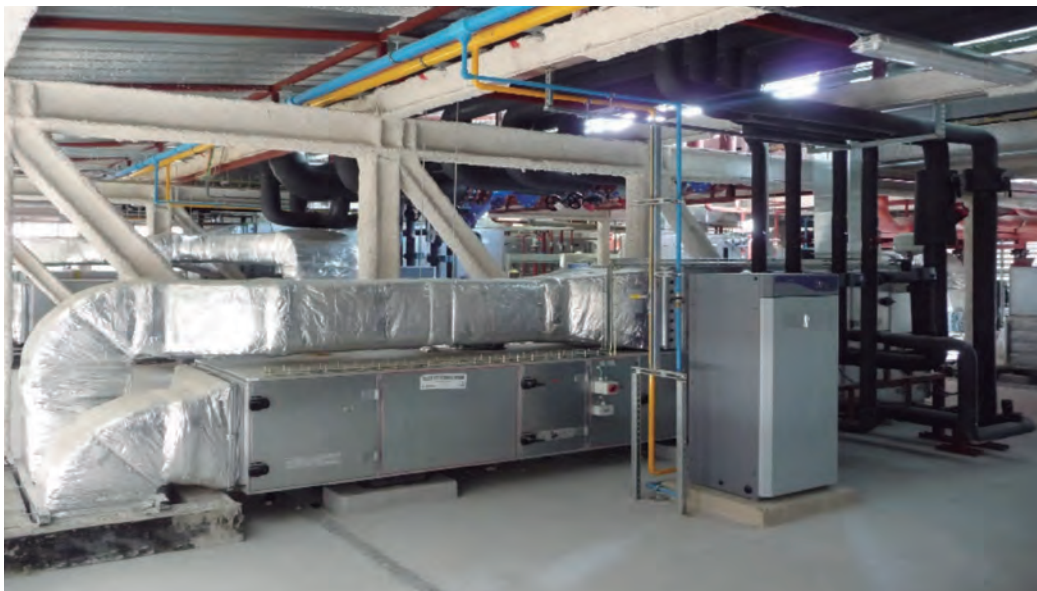
Sala de climatizadores del área quirúrgica
