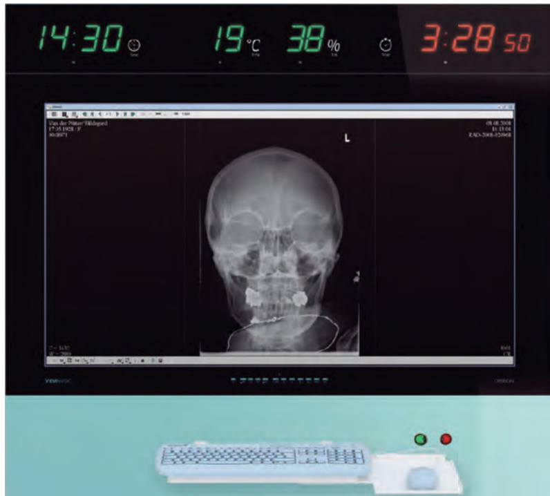
Panel técnico de mando y control instalaciones quirófano
