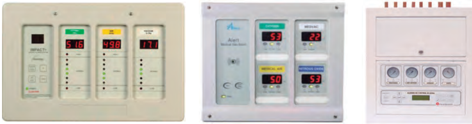
Paneles de control y alarma de gases medicinales
