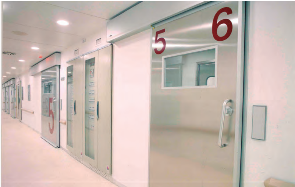
Ejemplo de cuadro eléctrico de mando y protección en pasillo BQ
