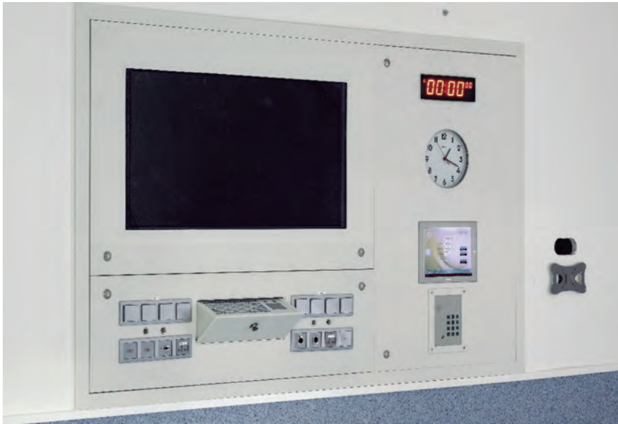
Panel técnico de mando y control instalaciones quirófano
