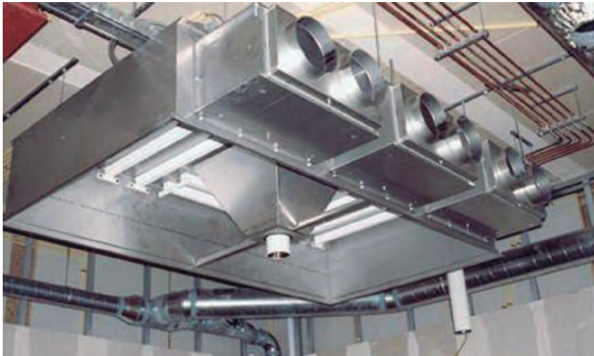
Plenum del flujo laminar de un quirófano de alta tecnología
