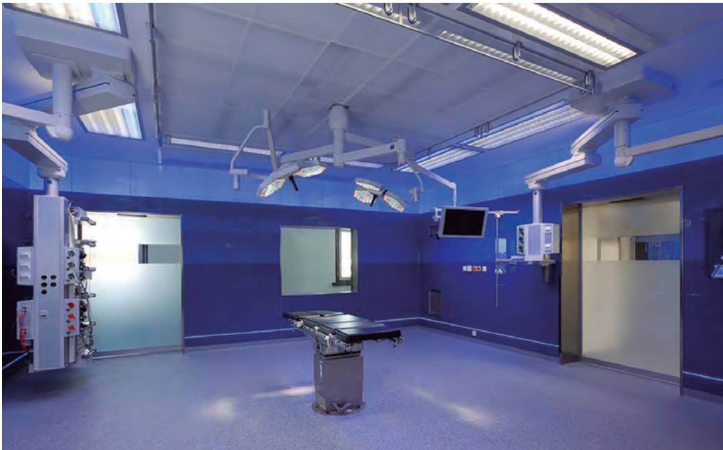
Vista interior de quirófano con flujo laminar
