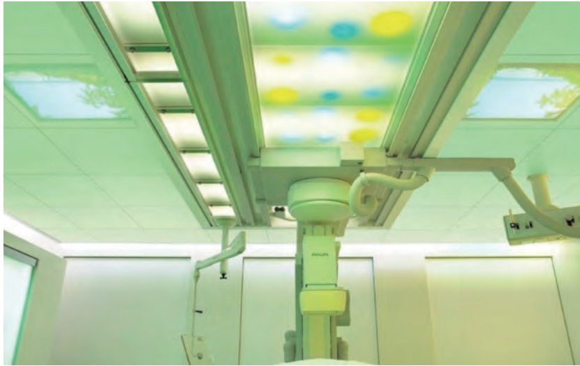
Sistemas de AED (Ambient experience design) en techos quirófono
