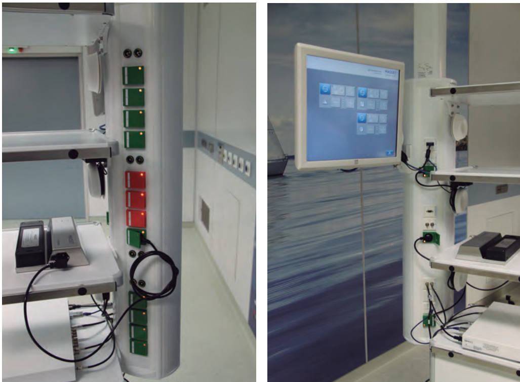
Diferentes ejemplos de torreta y bandeja portaequipos en interior quirófano
