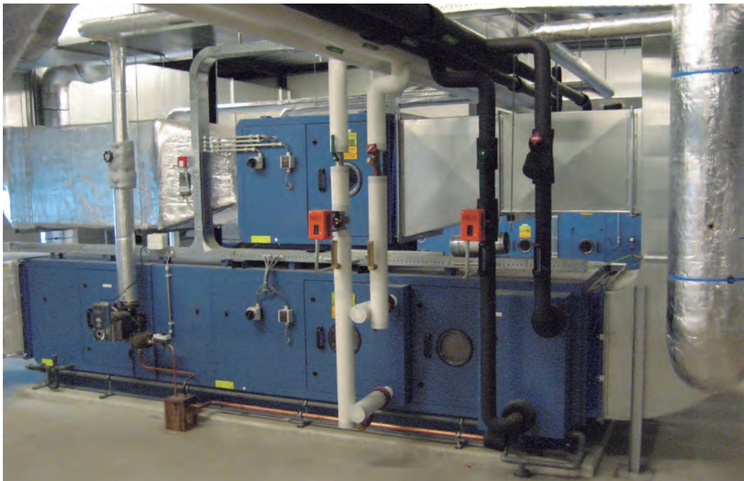
Climatizador de quirófano
