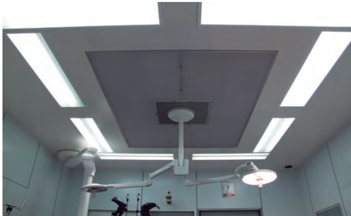
Sistema integrado de iluminación ambiente en techos de flujo laminar
