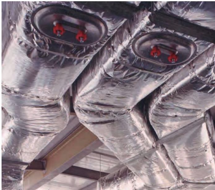
Conductos de impulsión y retorno
